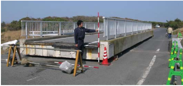
写真-1 流失した桁
