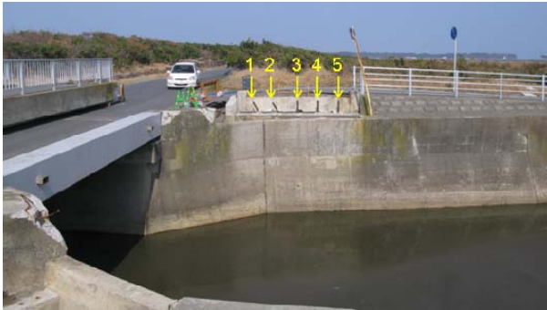
写真-2 桁流失後のアンカーバー
